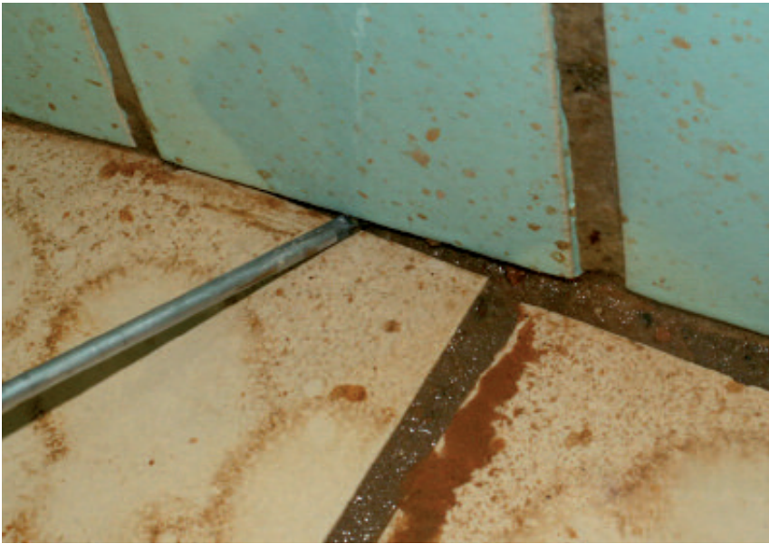
Das Fugenmaterial ist aufgeweicht und abgesandet
