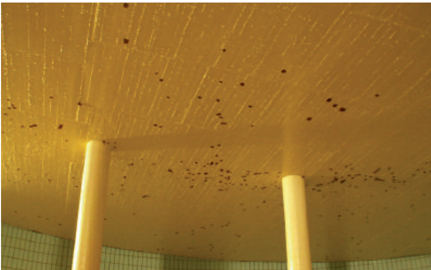
Korrosionsstellen an der Wasserkammerdecke
